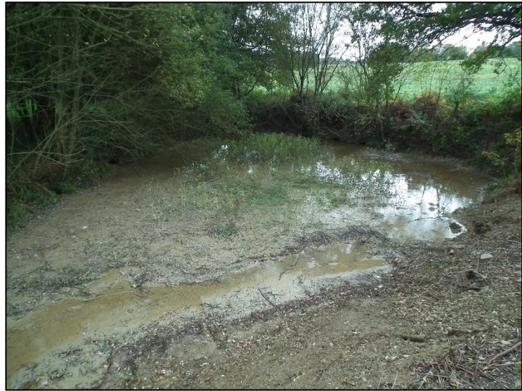
Figure 5: Bassin de rétention en cours d'atterrissement
