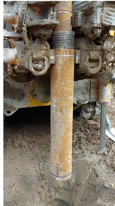
Tubage à l'avancement mis en place lors de la foration du Pz3 (diamètre 168 mm) jusqu'à 4m50 et poursuite au marteau (diamètre 155 mm)
